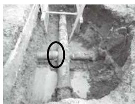
漏水箇所の確認
